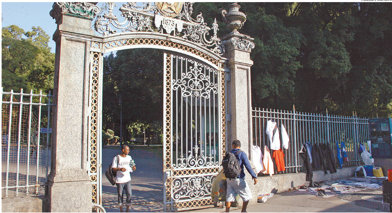
Além da depredação das ponteiras do gradil, o Campo de Santana, no coração do Centro, tem lixeiras quebradas e até fiação exposta
